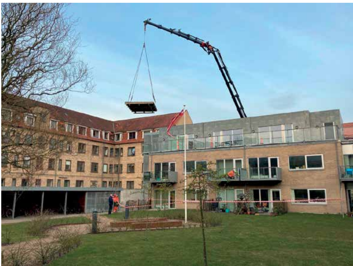
Udskiftning af revnede altaner
