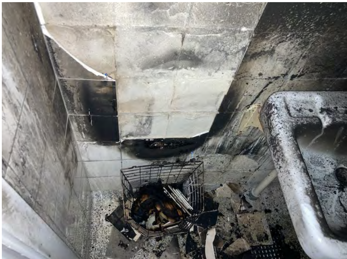
Toilettet skal renoveres
