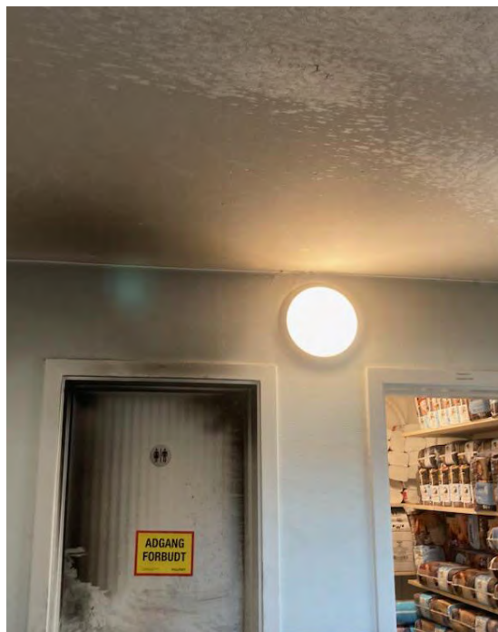
Der er kun begrænset skade i opgangen.
